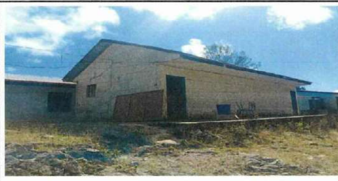
Foto 2: Parte posterior de las aulas, se requiere repello y pintura. Y torta de concreto
