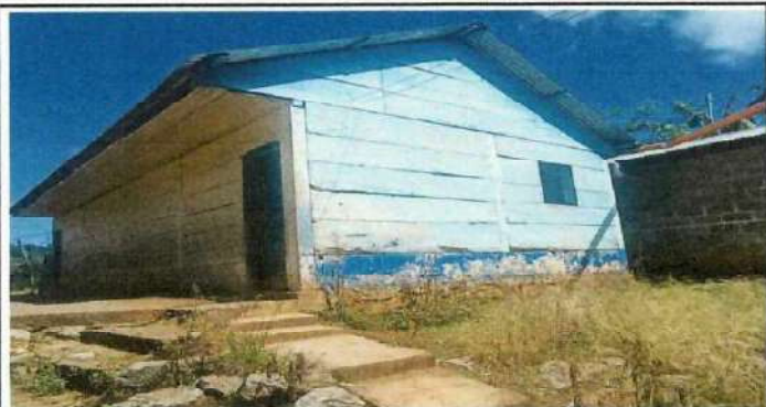
Foto 1: Parte inferior del aula, se requiere pintura, pisos, mejorar las puertas y ventanas.
